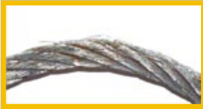
Fot. 4. Skutek korozji liny stalowej stosowanej jako prowadnica sztywna urządzenia samozaciskowego
