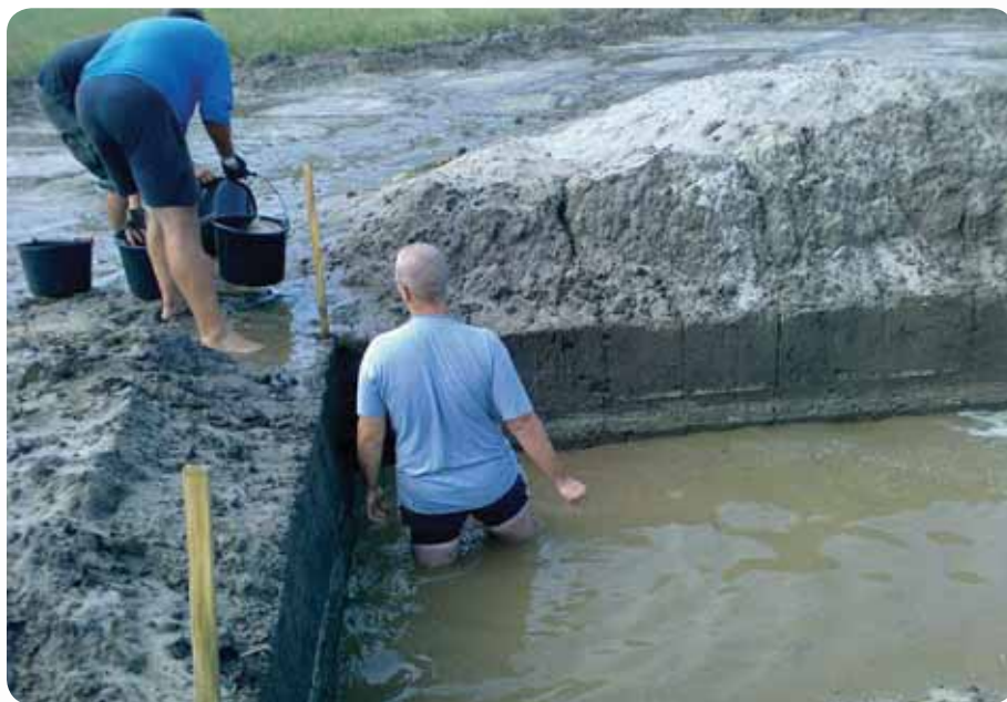
Fot. 3. Usuwanie wody z zalanego deszczem wykopu, praktykanci we własnej odzieży, bez obuwia i jakichkolwiek środków ochrony indywidualnej
