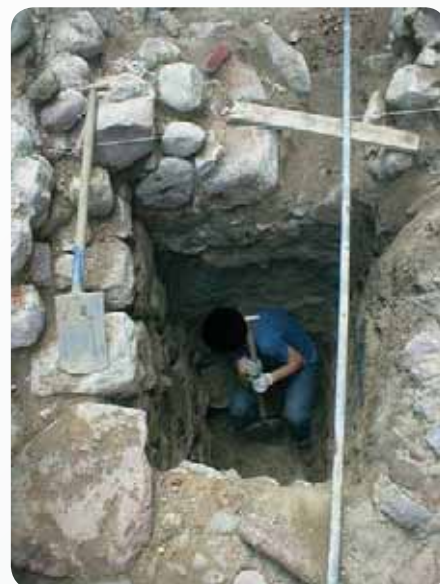
Fot. 4. Student pracujący bez kasku w szybie o głębokości ok. 3 m, na krawędzi szybu widoczne przedmioty stanowiące potencjalne zagrożenie
