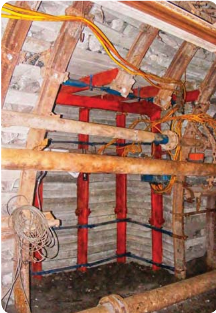
Rys. 4. Zdjęcie wnętrza technologicznego (przekop 106b poziom 840 m)
