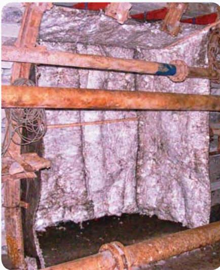
Rys. 5. Zdjęcie wnętrza technologicznego z adaptacją akustyczną (przekop 106b poziom 840 m)
