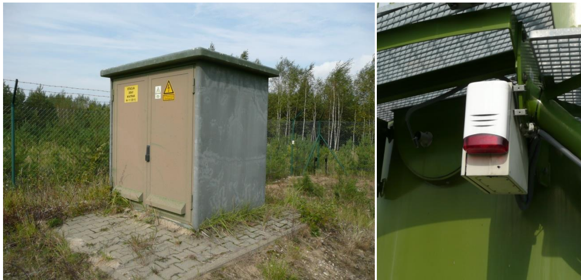
Rys. 10: Ogrodzenie transformatora i sygnalizacja alarmowa w elektrowni wiatrowej
