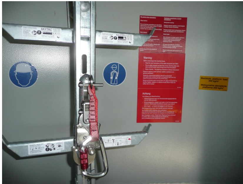
Rys.8: Urządzenie samozaciskowe do bezpiecznego przemieszczania się po drabinie wieży turbozespołu.
