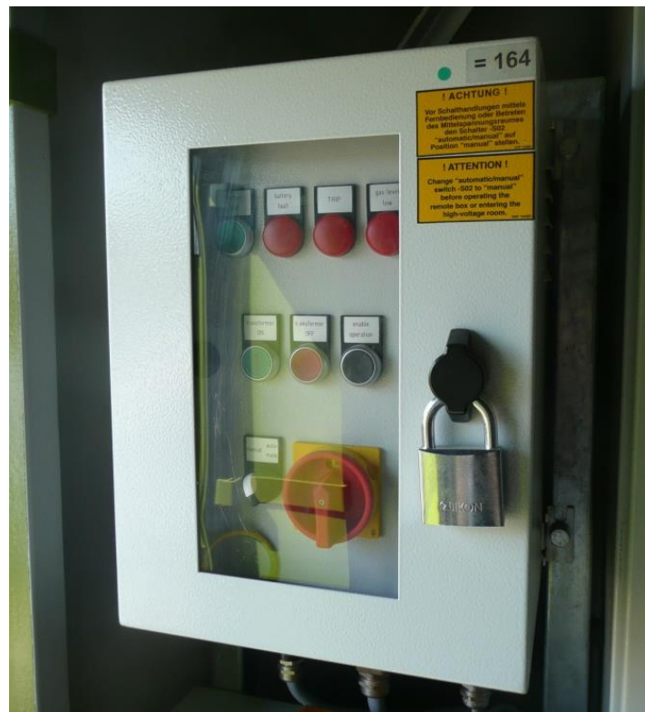
Rys. 4: Szafka z wyłącznikiem głównym na dolnym poziomie wieży
