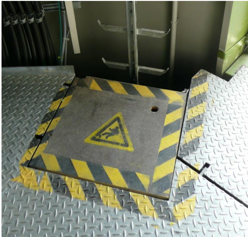
Rys. 7: Pokrywa włazu i fragment drabiny wewnętrznej elektrowni wiatrowej
