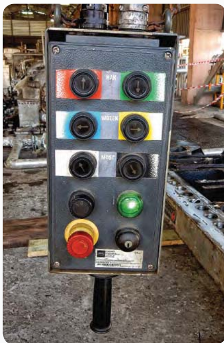
Fot. 7. Kasetka sterująca i wyłącznik awaryjny STOP Photo 7. Pendant control and emergency switch
