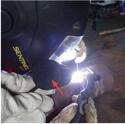
Fot. 1. Pomiar promieniowania UV z wykorzystaniem opracowanego modelu mobilnego systemu pomiarowego na przykładowym stanowisku pracy spawacza (strzałką zaznaczono detektor pomiarowy)
